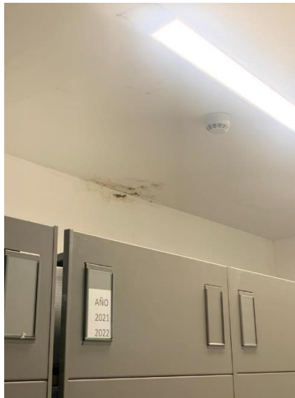
Ilustración 88 Afectación de cielorraso por humedad
