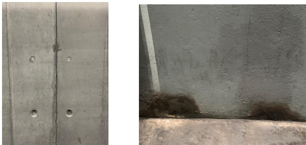
Ilustración 158 Grietas y humedad en muros
