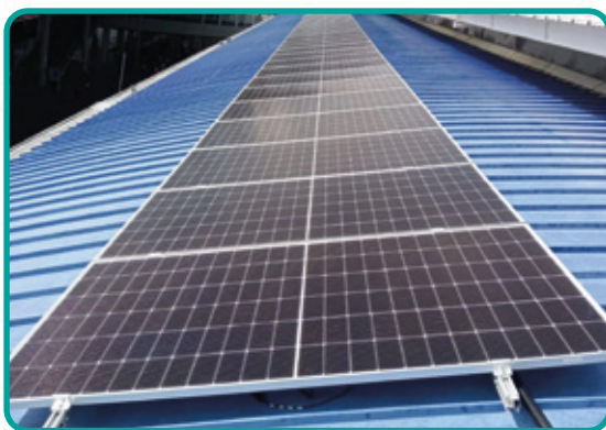
Paneles solares ubicados en el SuperCADE 20 de Julio
